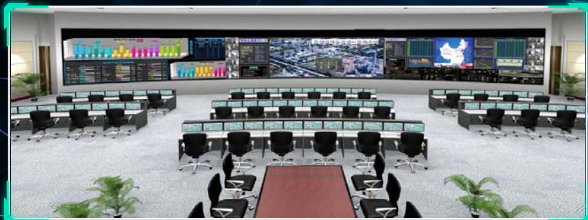
中央控制全厂调度中心
